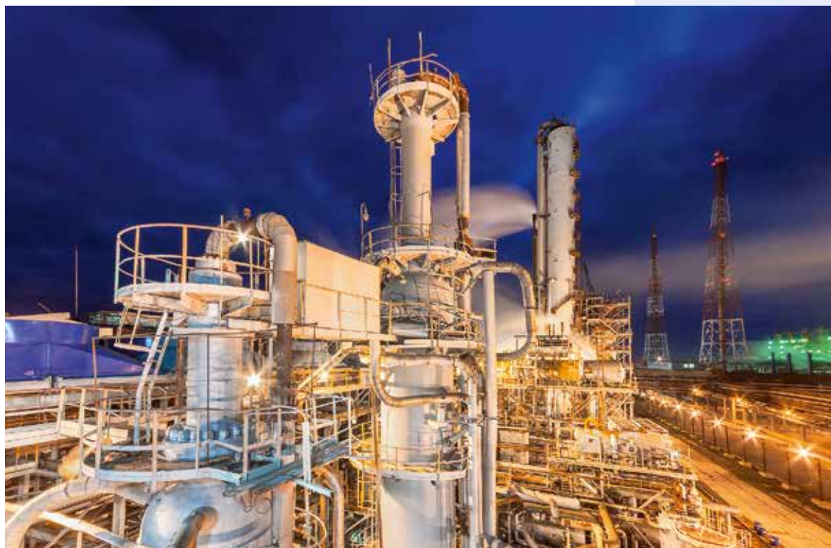
Εικόνα 5.75: Εργοστάσιο παραγωγής αμμωνίας.
