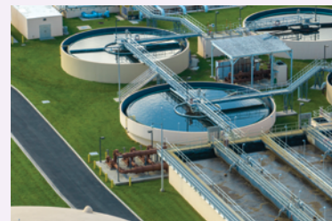
Εγκαταστάσεις επεξεργασίας των αστικών λυμάτων
