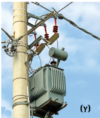
Εικόνα 2.3.14: (γ) Μετασχηματιστής ΔΕΔΔΗΕ.
