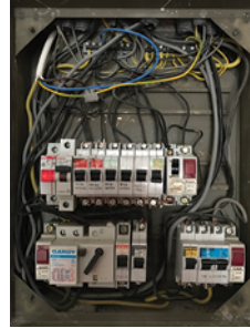
Εικόνα 1.6.11: Ο οικιακός ηλεκτρολογικός πίνακας.
