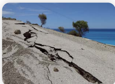
B.6.4 Καταστροφή στο οδικό δίκτυο Γιαλού Λευκάδας, 2015
