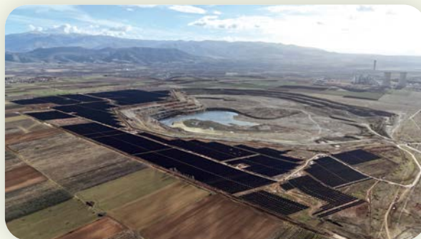
Γ.5.8 Φωτοβολταϊκό πάρκο της ΔΕΗ Ανανεώσιμες στο ορυχείο λιγνίτη του Αμυνταίου
