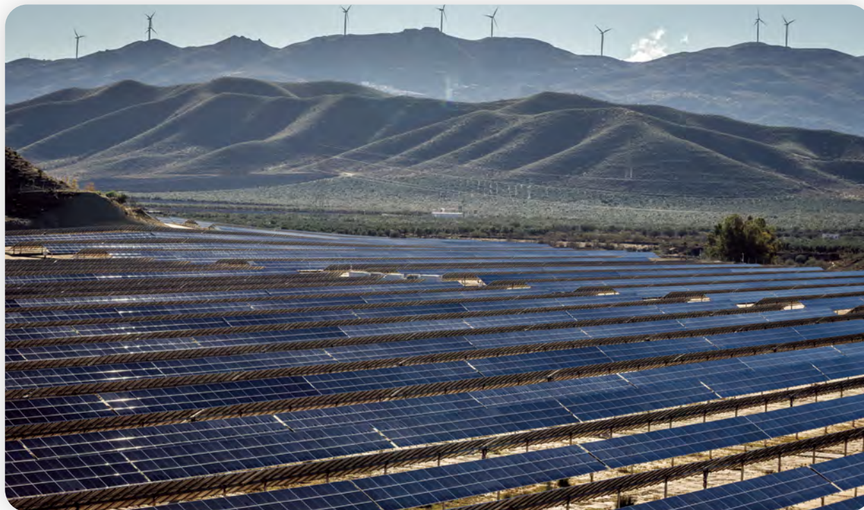
Γ.6.4 Φωτοβολταϊκό πάρκο στην Αλμερία της Ισπανίας
