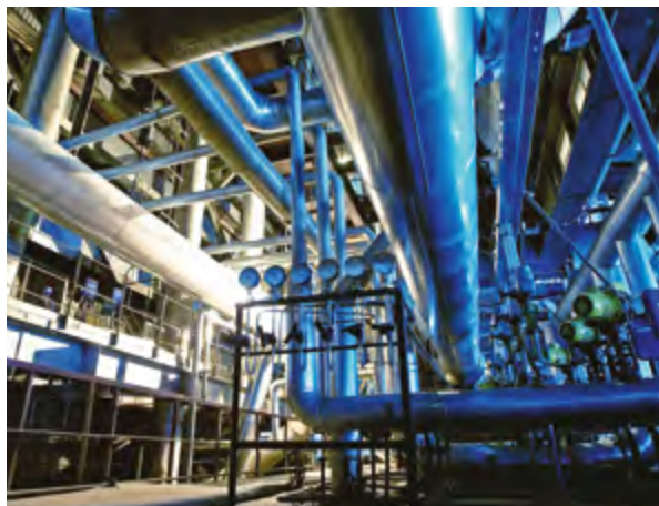
Εικόνα 1. Μονάδα παραγωγής Ενέργειας
