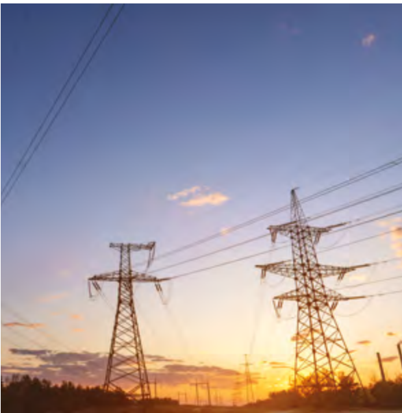
Εικόνα 3. Πυλώνες μεταφοράς ενέργειας
